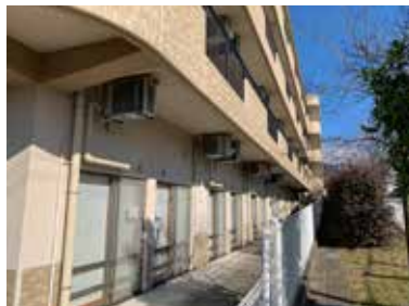
写 3-4 1階の空き室を更衣室として 使用 ベランダからアクセスできる （B 施設）
